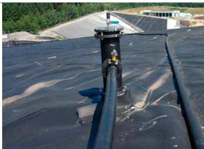
Gasbrunnen auf der Deponie Leppe
