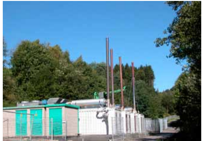
Leppe Deponie, Blockheizkraftwerk
