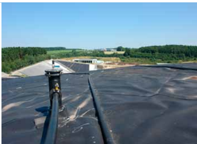
Gasbrunnen Deponie Leppe
